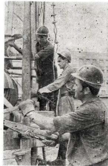
Бурение скважин на «Размыве». Бригада бурльщиков СМУ-9 (слева направо): А. Романцев, бригадир, В. Желудев, Э. Кантыньш
