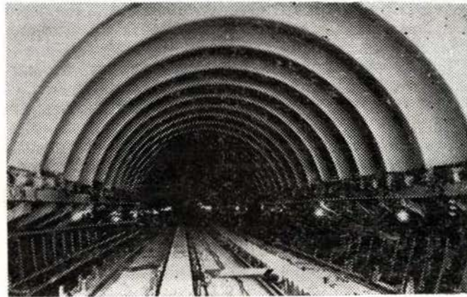
Армоцементные зонты, установленные в эскалаторном тоннеле ст. «Площадь Мужества»
