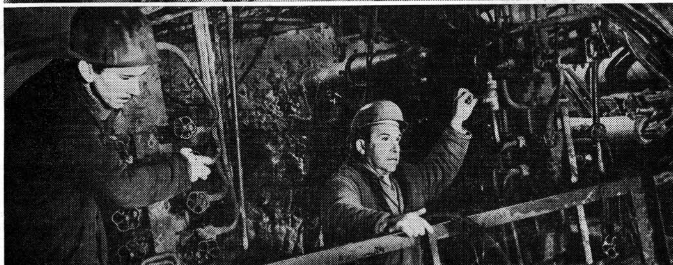
На снимках (сверху вниз): строители Управления № 157 — сменный инженер В. Коновалов и звеньевой П. Агапов (первый снимок), бригадир бурильщиков В. Авдонин (второй снимок) ведут работы по замораживанию грунтов под рекой Лузой. На нижнем снимке — сооружение тоннеля Рижского радиуса. Проходчики Тоннельного отряда № 6 В. Королев (слева) и машинист щита А. Усанов в момент передвижки агрегата.
